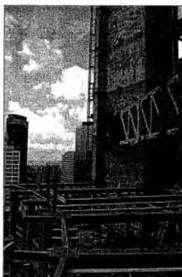
13. Un volta terminate le operazioni di cantiere, commissionate dal ministero dei Lavori pubblici - Provveditorato alle Opere pubbliche della regione Campania, e superate le gravi condizioni di degrado visibili nell'immagine, l'edificio tornerà alla sua piena funzionalità con un'efficienza strutturale ritrovata.
