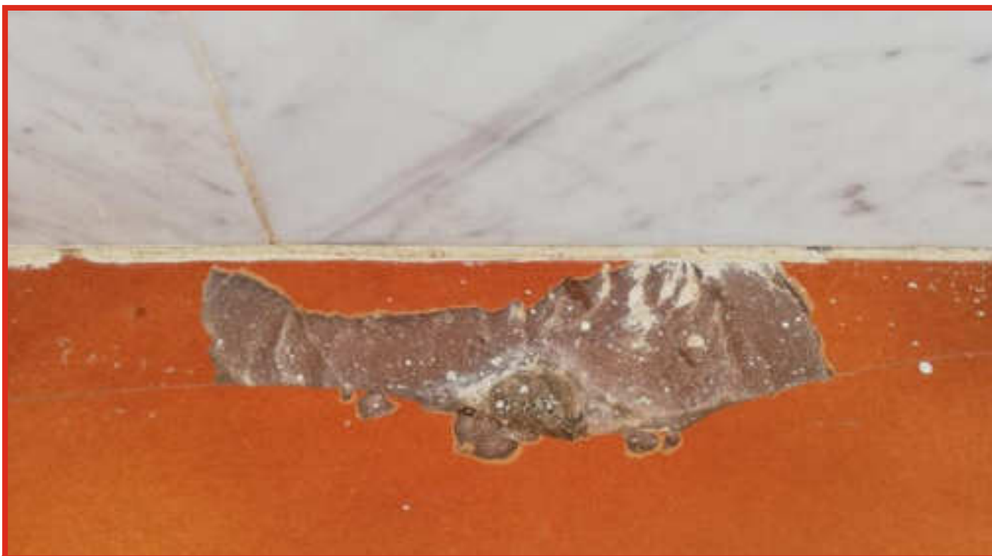
Foto n.17 Vista dettaglio danni pavimento balcone 2° piano interno n.9
