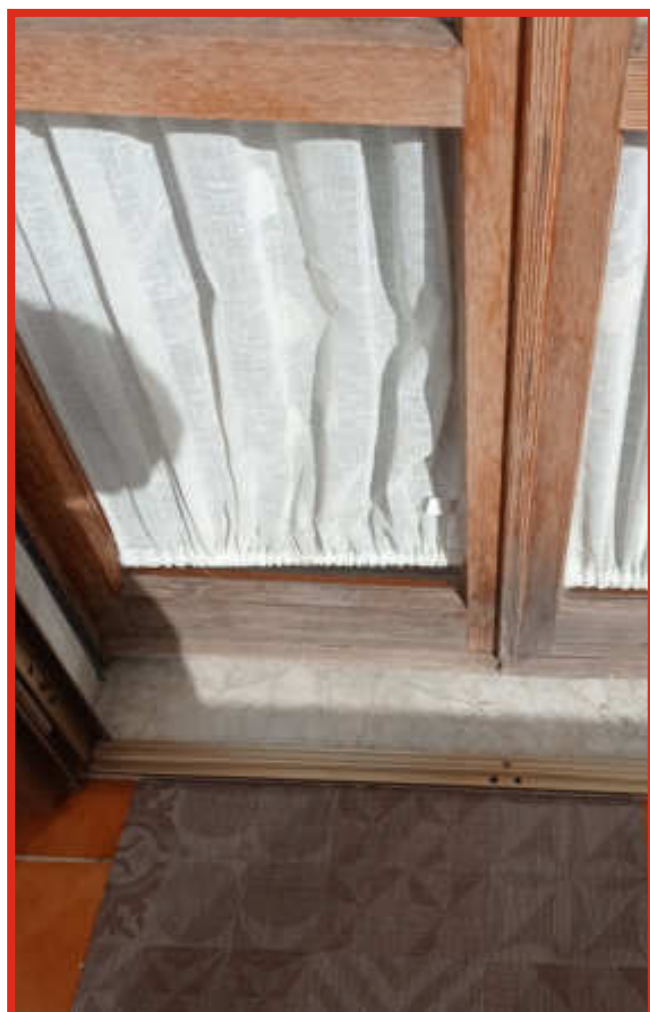
Foto n.15 Dettaglio infisso, stillicidio interno balcone
