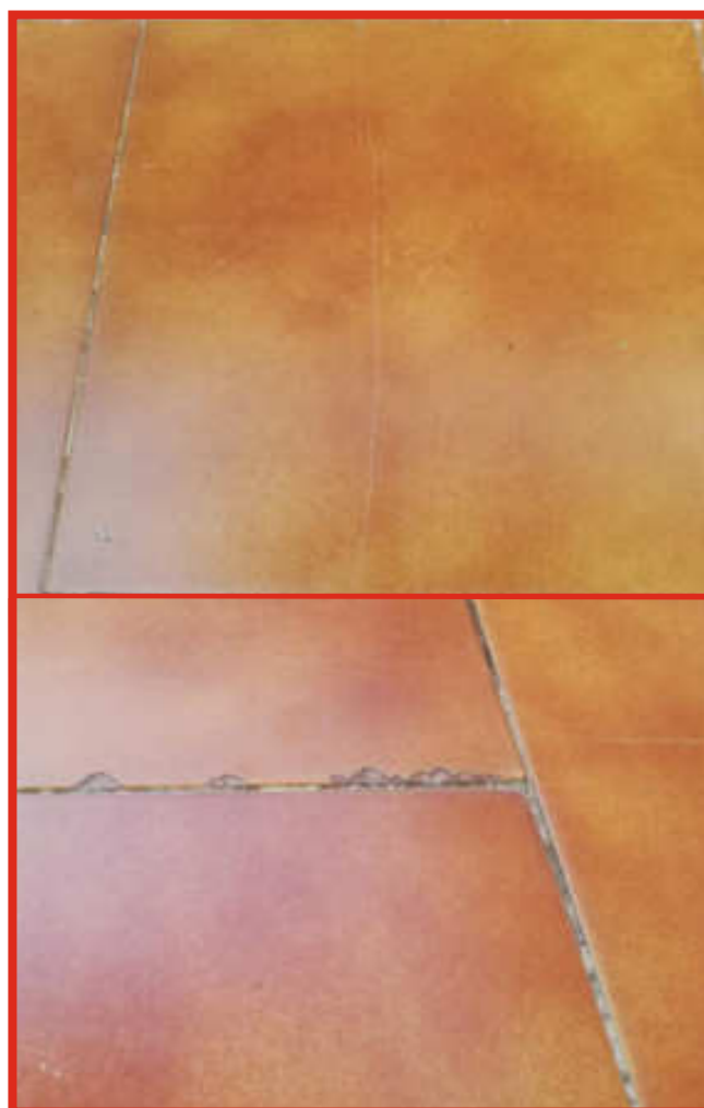
Foto n.19 Vista danni pavimento balcone
