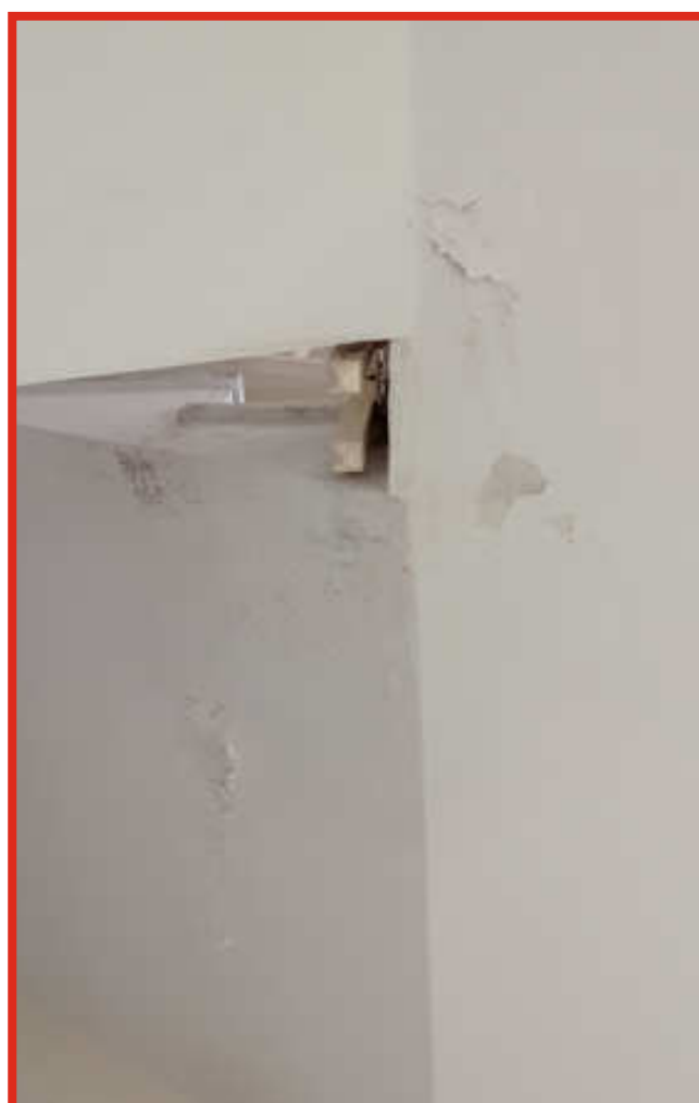
Foto n.10 - sfogliatura pittura soffitto ballatoio
