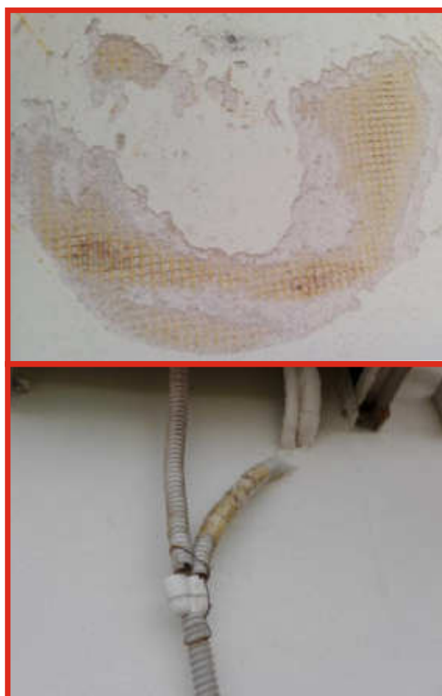
Foto n.16 Dettaglio tubo scarico condizionatore
