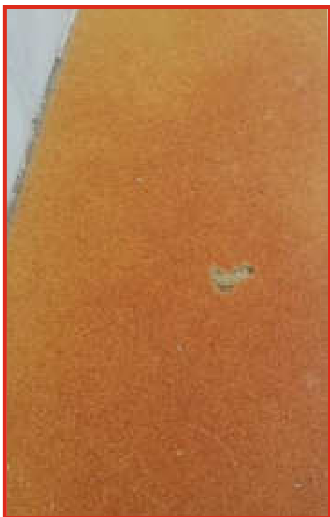
Foto n.18 Vista danni pavimento balcone
